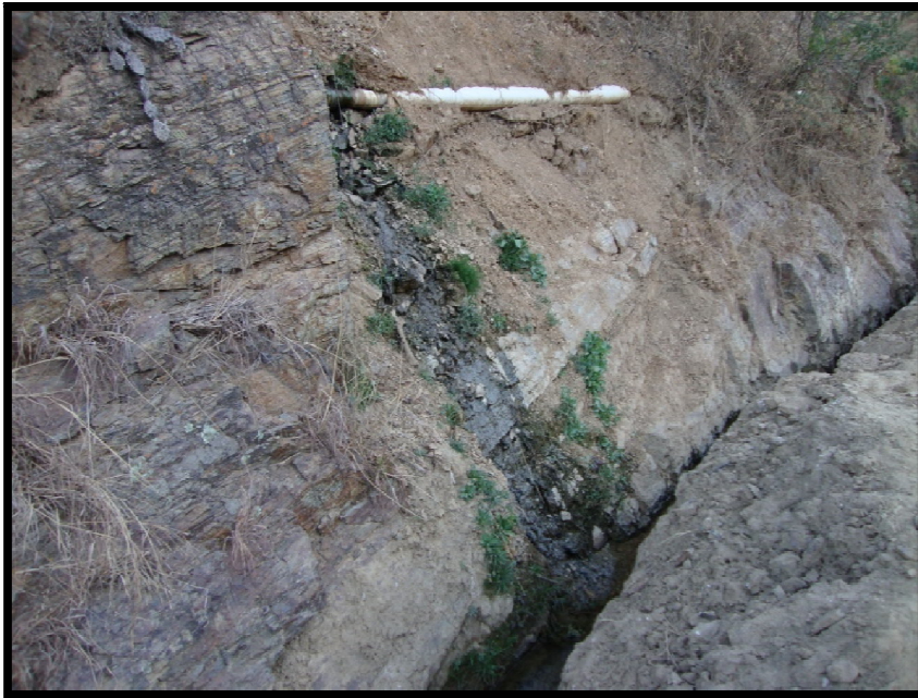
Fotografía 2. Interceptor del angosto de Tomatitas, contaminando un canal de riego.
