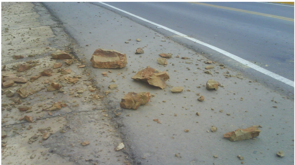
Derrumbe de parte del talud
