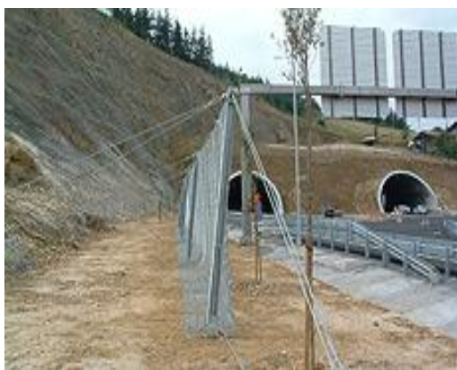
Barreras (Protección contra desprendimientos)
