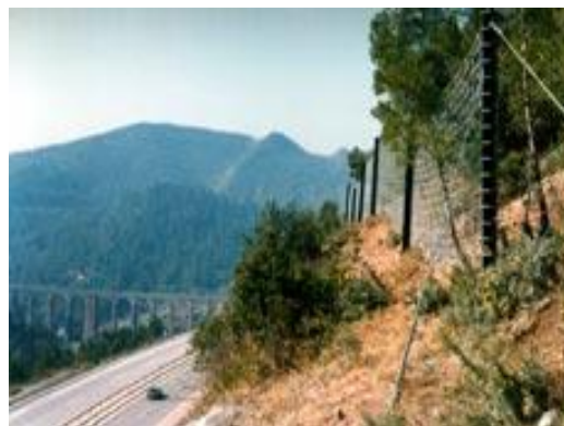
Disposición de barreras fijas en el cuerpo de un talud.
