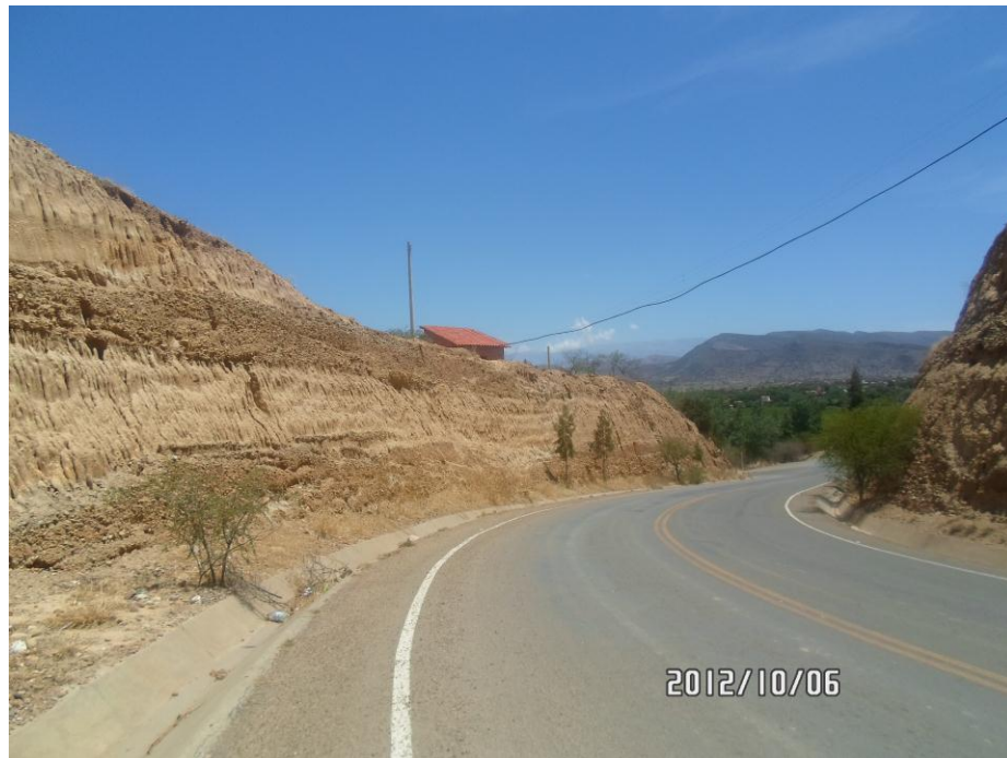
Fotografía 5.11 Talud N° 3 después de la época de lluvias.
