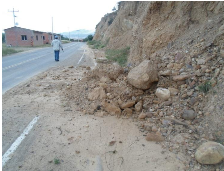
Fotografía 5.4 Talud 1 después de las lluvias.
