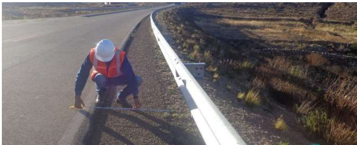
Figura Nro. 40 Ubicación de la barrera de seguridad
