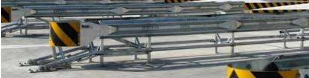
Figura Nro. 2 Terminales de barrera
