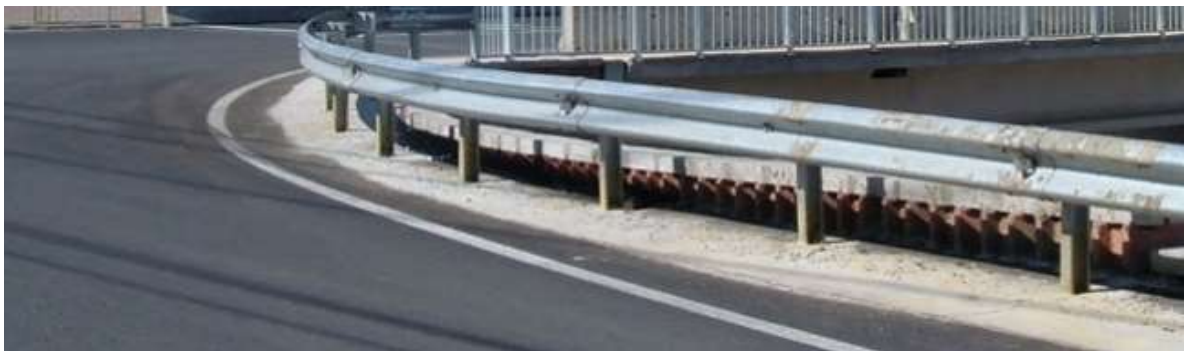
Figura Nro. 1 Barreras de seguridad
