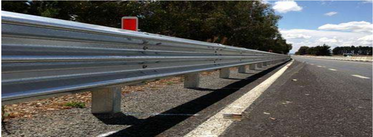
Figura Nro. 36 Guardarraíl de viga thrie
