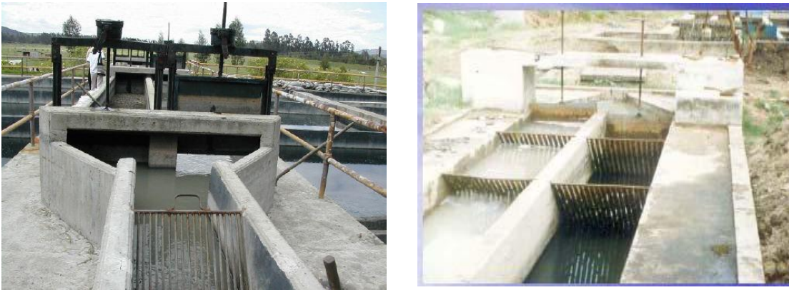
Fotografía 4.1 Rejilla fija con limpieza manual
