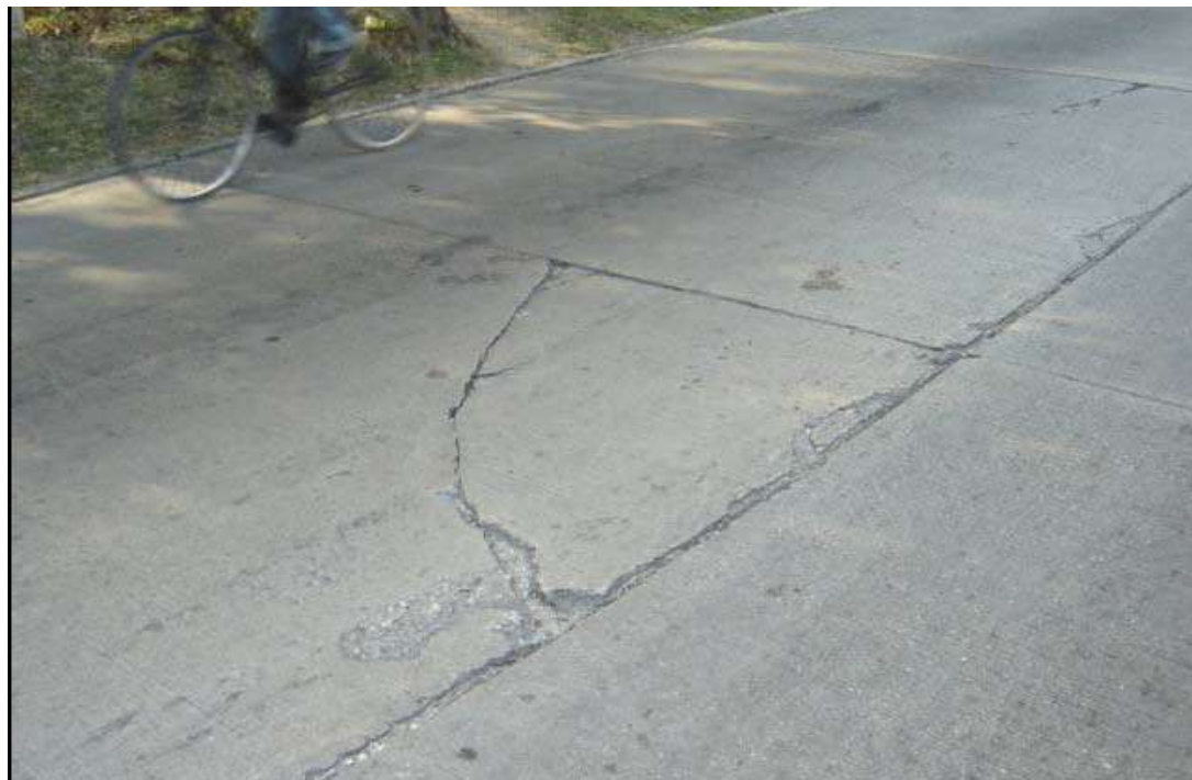
Figura 2.3 Vista típica de una grieta de esquina
