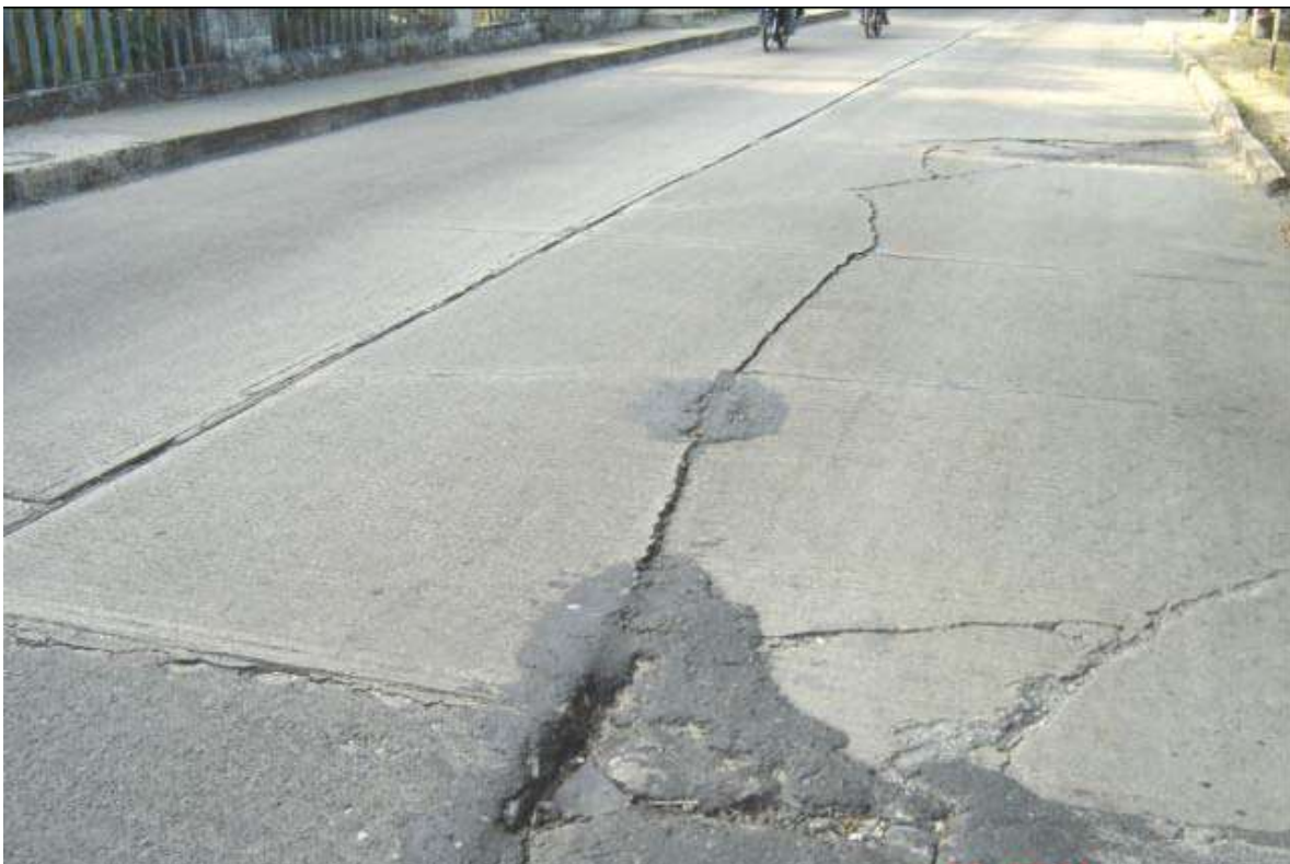
Fotografía 2.11 Vista típica de las grietas en bloque
