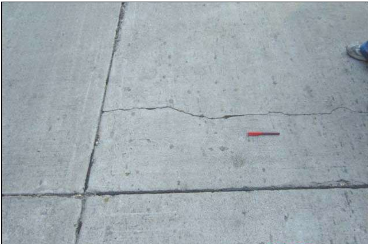
Fotografía 2.9 Vista típica de una grieta en los extremos de los pasadores
