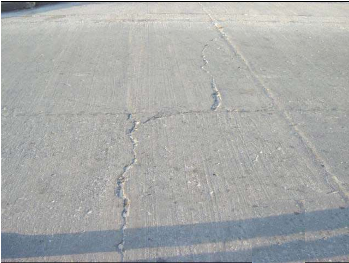
Figura 2.7 Vista típica de una Grieta Transversal.
