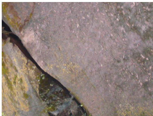
Fig. 4.19 Fisura al pie del talud.
