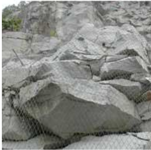
Fig. 2.12 Mallas de protección en taludes rocosos.
