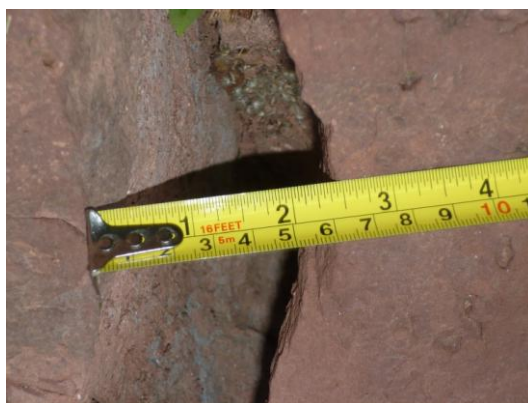
Fig. 4.20 Medición de la fisura al pie del talud.
