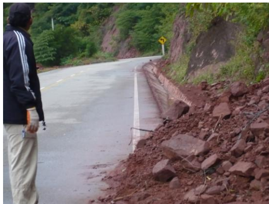
Fig. 4.11 Invasión a las cunetas de material rocoso.
