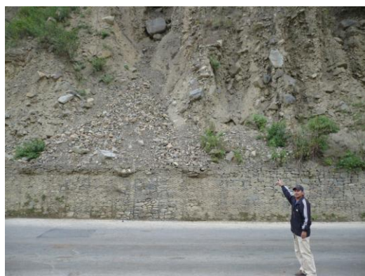
Fig. 4.7 Derrumbes en el tramo.
