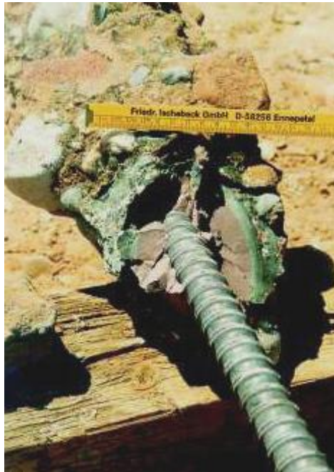
Fig. 3.23 Adherencia lechada de cemento-acero.
