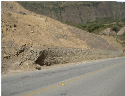
Fig. 4.5 Gaviones en mal estado.
