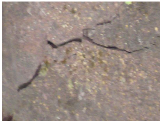
Fig. 4.18 Fisuras en el talud de estudio.
