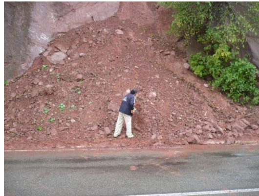
Fig. 4.15 Derrumbes en el sector de estudio.
