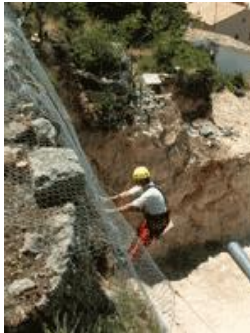
Fig. 2.11 Mallas de protección en taludes conglomerados.
