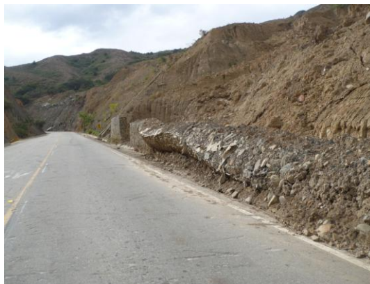
Fig. 4.6 Pantallas Dinámicas (gaviones) colapsadas.
