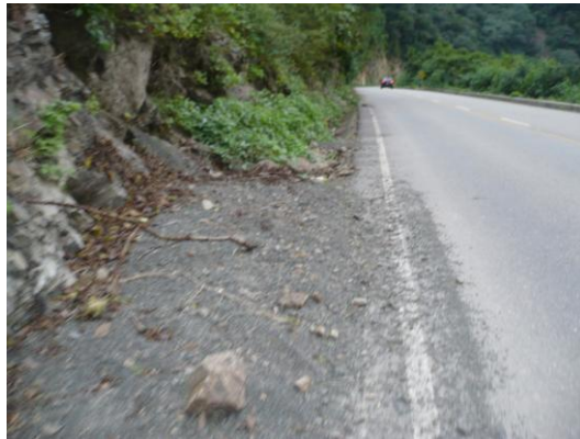
Fig. 4.10 Obstrucción de la calzada y cunetas por masas rocosas.
