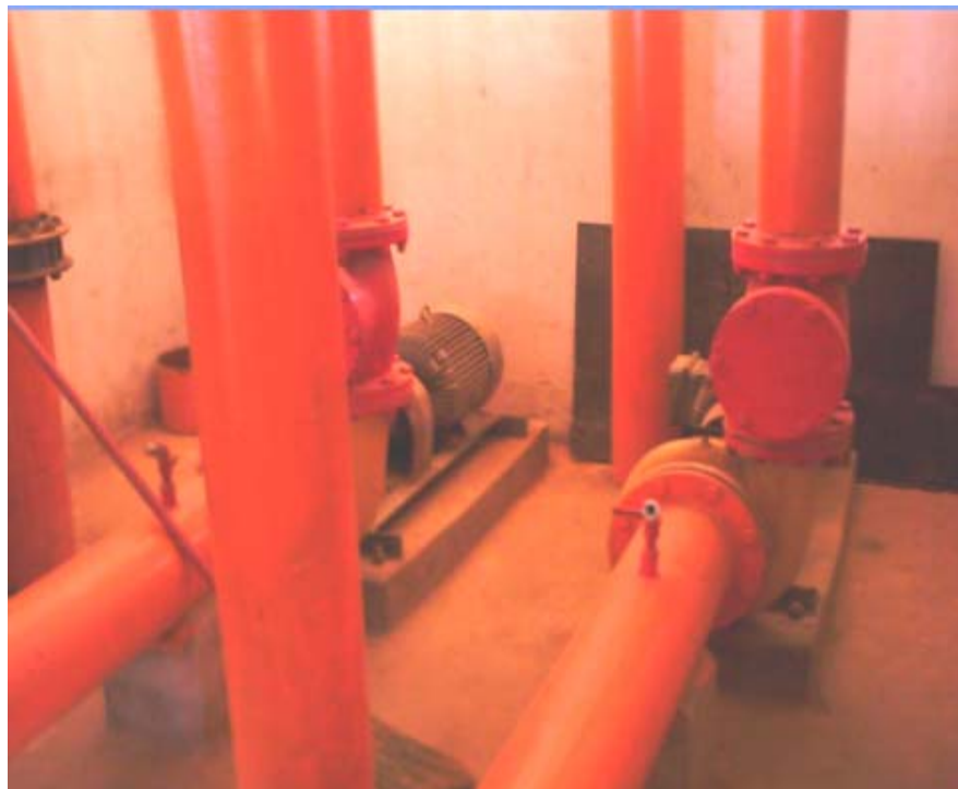
Foto 9: Bombas en paralelo que impulsan el sistema instalado en el Laboratorio de Hidráulica (con capacidad de 150 l/s) a una altura geométrica de 10 metros.
