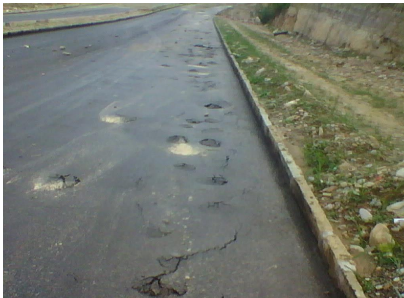
FIGURA 5. Daños ocasionados en la Av. Integración
