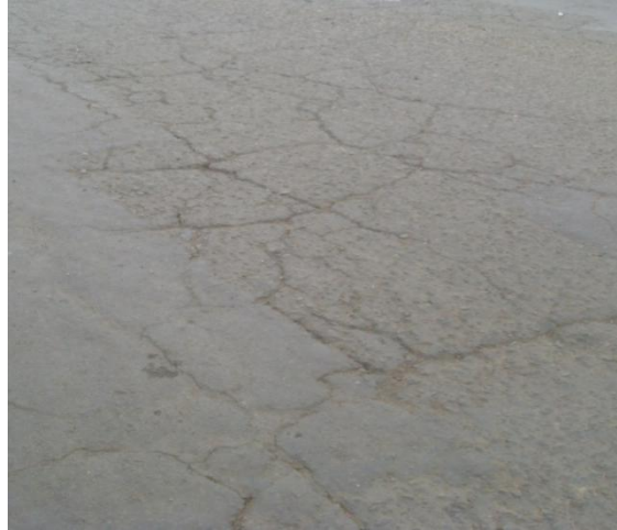
Figura 4.5. Grietas en Bloque
