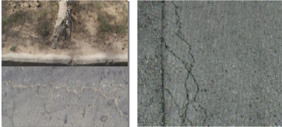
Figura 3.7 Grietas de Borde
