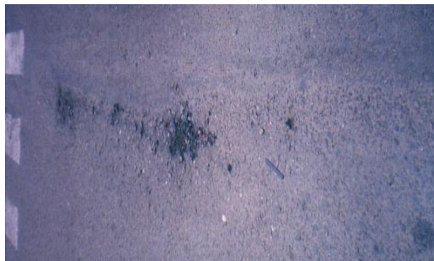
Figura 3.19 Desintegración Del Pavimento
