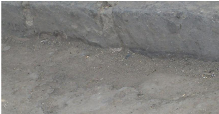
Figura 4.6. Grietas de Borde
