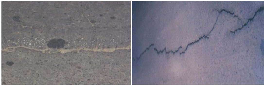
Figura 3.10 Grietas longitudinales y transversales
