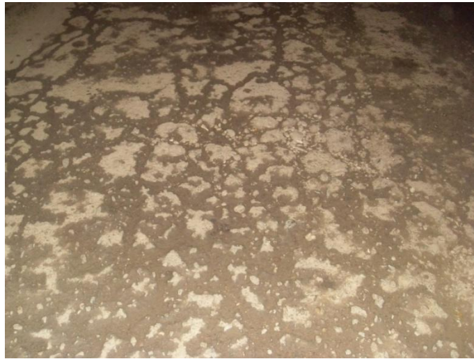
Figura 4.10. Desprendimiento de Agregados
