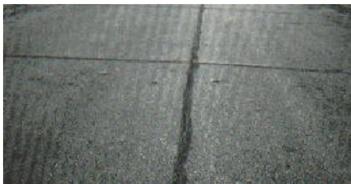
Figura 3.8 Grietas de Reflexión o de Juntas
