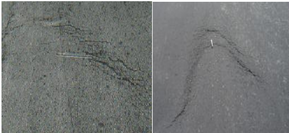
Figura 3.17 Grietas de Deslizamiento
