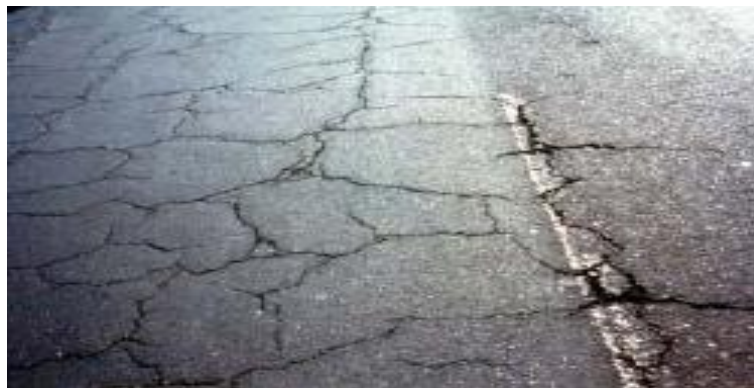
Figura 3.3 Grietas De Contracción
