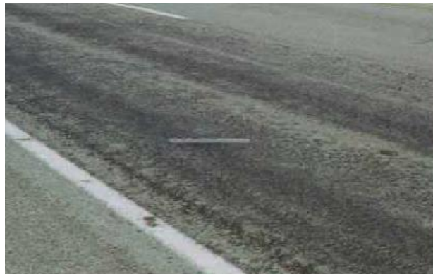
Figura 3.2 Exsudación Del Asfalto
