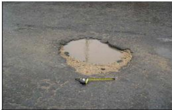
Figura 25 Aspecto superficial de un bache profundo en pavimentos flexibles
