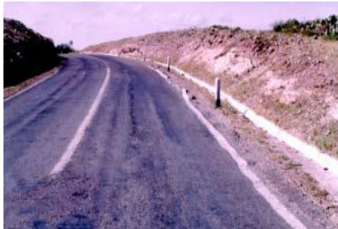
Figura 24 Aspecto superficial de canalizaciones en pavimentos flexibles
