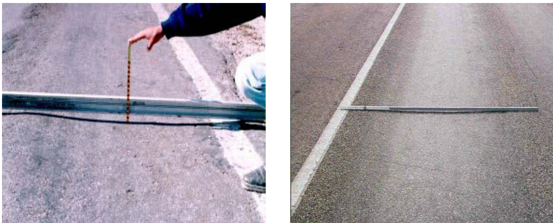
Figura 21 Deformaciones permanentes (roderas) en pavimentos flexibles
