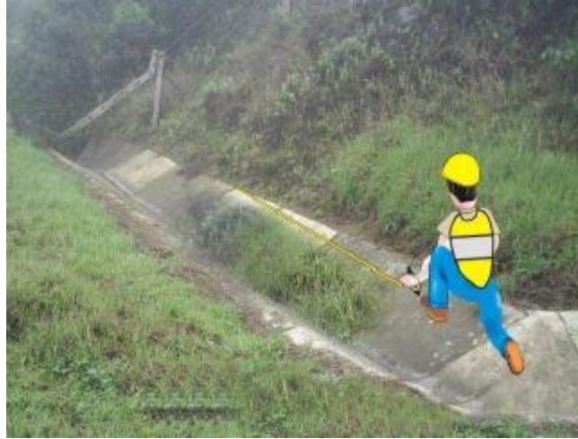
Figura 27. Obstrucción de disipadores, zanja de coronación y canales
