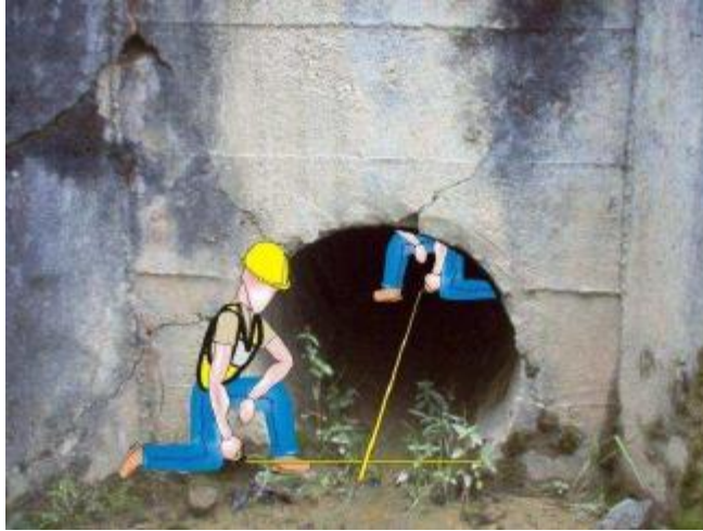
Figura 38. Obstrucción de alcantarilla
