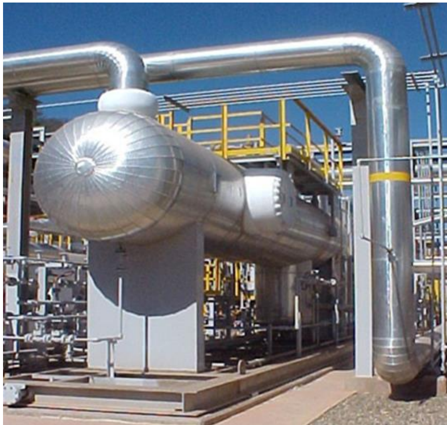
Fig. 2- 5 Separador de Frío
