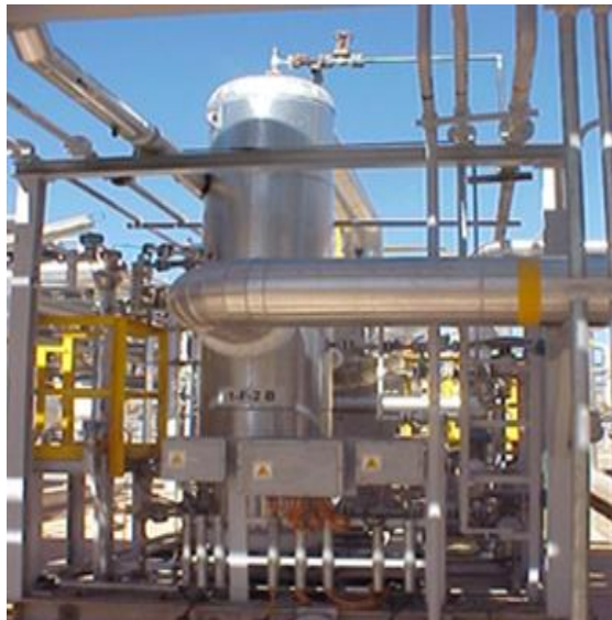
Fig. 2- 4 4 Filtro Separador de Gas de Salida
