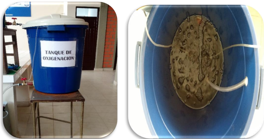
FOTO 2-2 TANQUE DE OXIGENACIÓN
