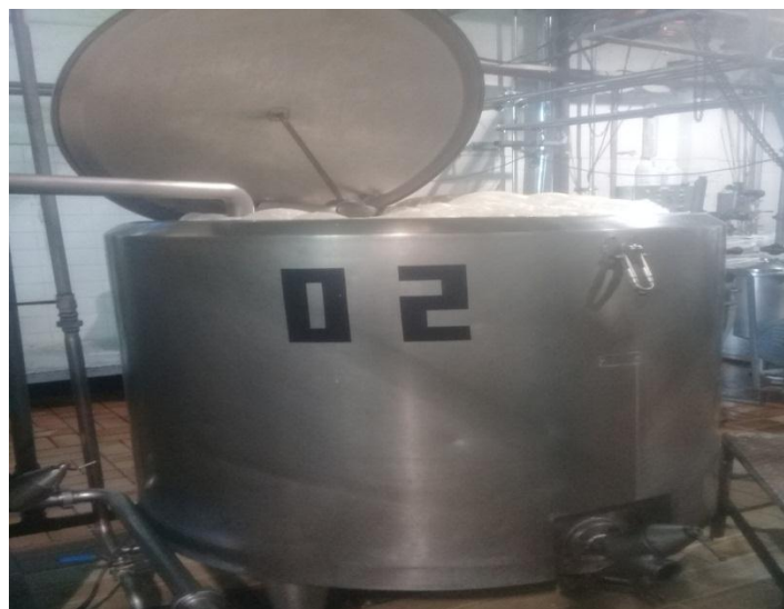
Figura 3-21: Tanque de agitación de PIL Tarija S.A
