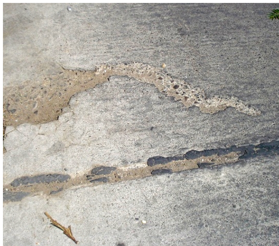
Figura 2.18 FALLA POR DESCASCARAMIENTO
