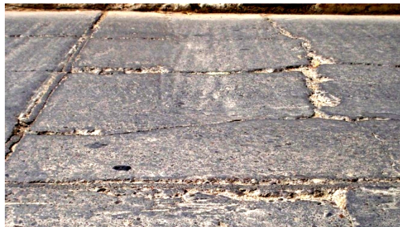
Figura 2.19 FALLA POR ASTILLADO
