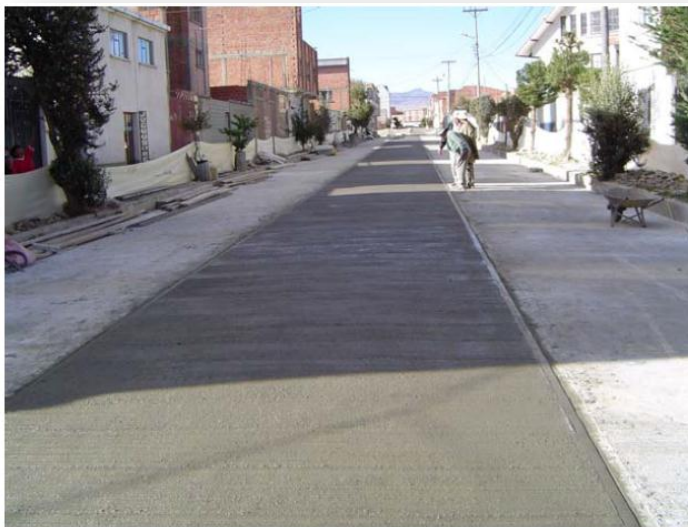
Figura 2.19 Junta longitudinal con barras de amarre esperando a las losas adyacentes. En el lado izquierdo se formará otra junta longitudinal
