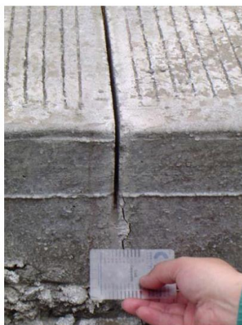
Figura 2.16 Formación de la fisura de retracción por debajo de una junta transversal.
