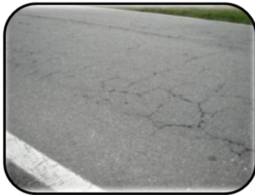
Formación de mallas grandes (>500mm), con fisuras finas, sin pérdida de material (prog 401+345)
