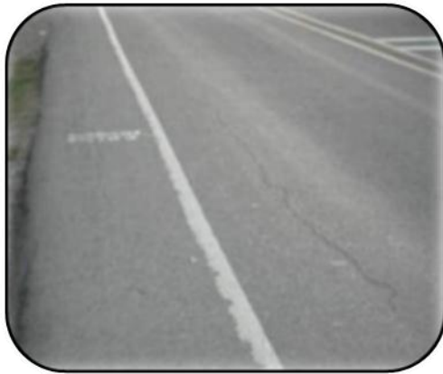
Fisuras finas en la huella de rodamiento < 6 mm (prog 402+456)
