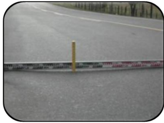
ahuellamiento 15 mm (prog 403+457)
