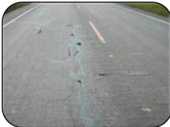
Fisuras muy ramificadas y/o muy abiertas. Bordes defisuras ocasionalmente degradados (prog 410+345)
