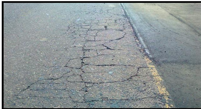
Imagen 5-2 de fisuración. Fuente elaboración propia
