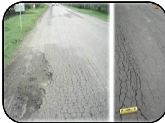
Presencia de mallas densas con fisuras muy abiertas y fragmentos separados (<200mm), con pérdida ocasional y/o generalizada de material. (prog 414+234)
