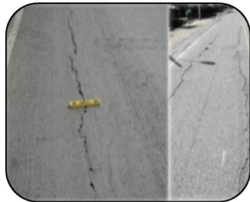
Fisuras abiertas y con cierta frecuencia se encuentran ramificadas. (prog 408+345)
