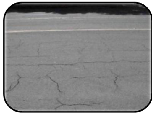
Presencia de mallas más densas (<500mm), con pérdida ocasional de material, desprendimiento y ojos de pescado en formación (prog 413+234)
