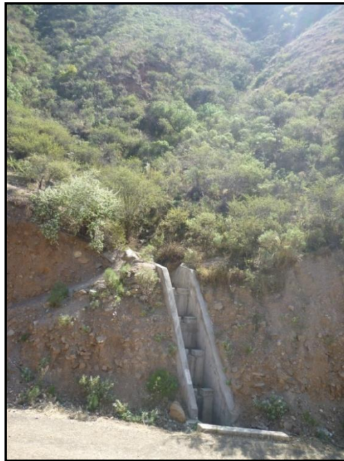
Fotografía N° 17 Rápidas escalonadas en Funcionamiento.
