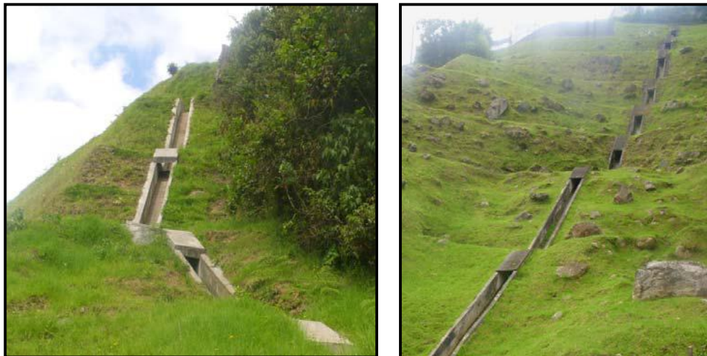
Fotografía N° 14 Canal de Rápidas con Tapas y Columpio
