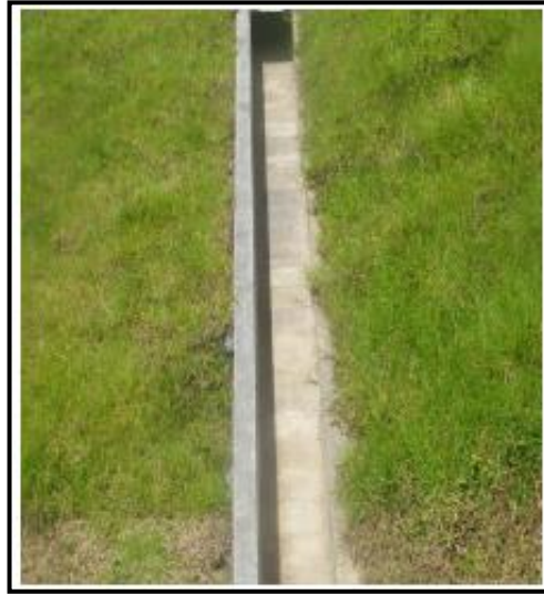
Fotografía N° 11 Rápida Lisa de Concreto
