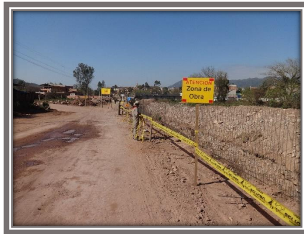
Fotografía N 5: Señalización
