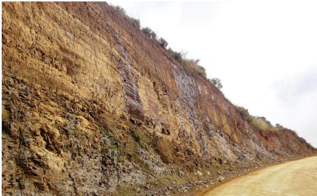
Fotografía 4B talud con escorrentía superficial
