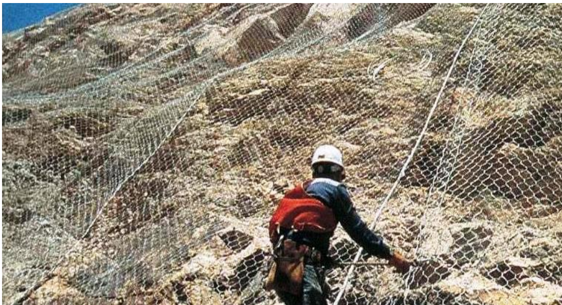
Fotografía 3C Malla Metálica de Protección Dinámica
