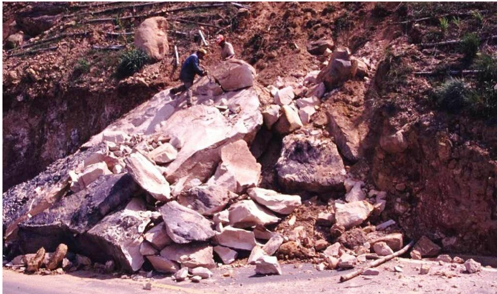
Fotografía 2D Un derrumbe
