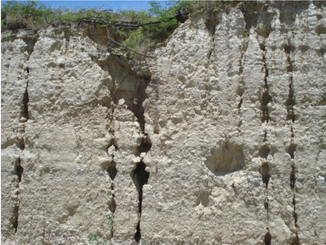
Foto 2F Degradación por erosión
