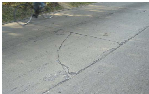
Figura 2.10 Fisura de esquina
