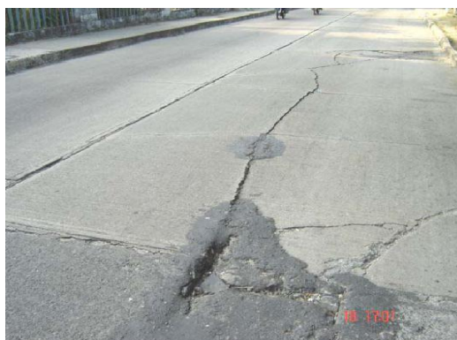
Figura 2.12 Fisuras en bloque
