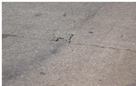
Figura 2.23 Fisuras por mal funcionamiento de juntas
