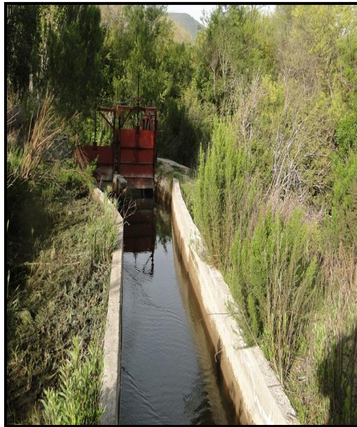
Figura 1.16: Compuerta de regulación
