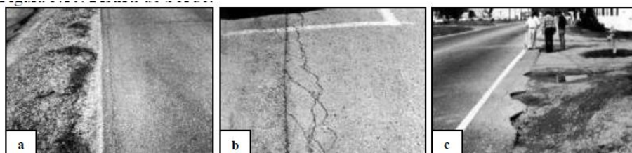
Figura 28. Fisura de borde de nivel de severidad bajo (a), medio (b) y alto (c).
