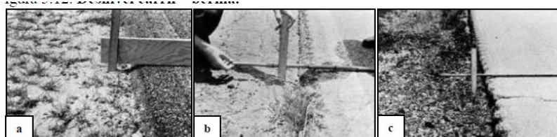
Figura 30. Desnivel carril - berma de nivel de severidad bajo (a), medio (b) y alto (c).
