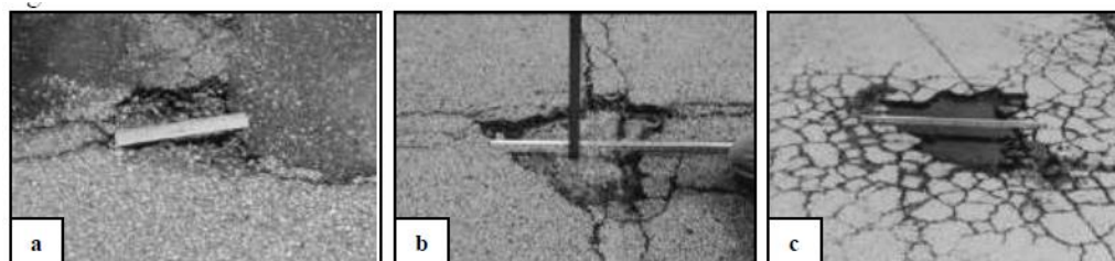
Figura 34. Baches de niveles de severidad bajo (a), medio (b) y alto (c).
