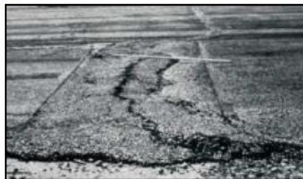
Figura 37. Hinchamiento de alta severidad.
