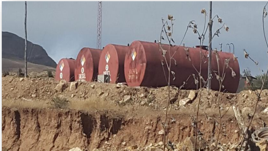
FIGURA N° 40 Tanques de almacenamiento de Diésel y gasolina
