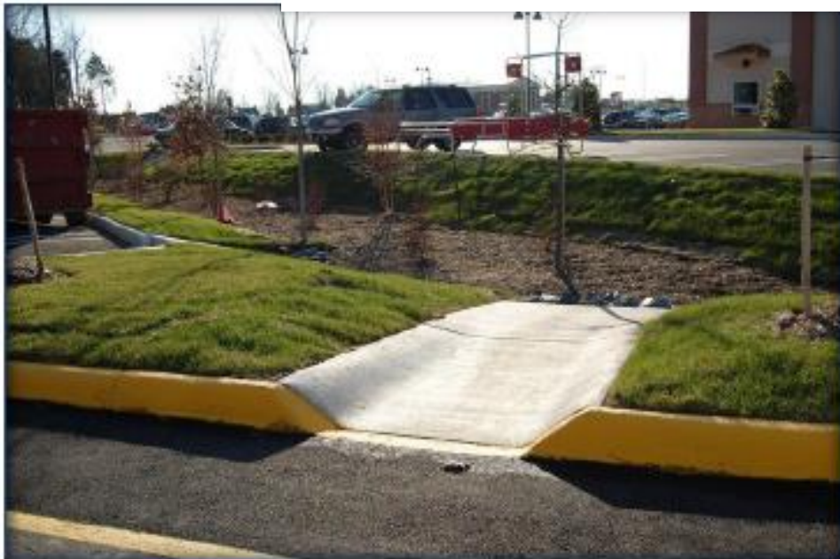
Imagen 4. Discontinuidad de sardineles
