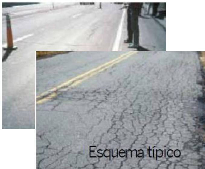
Figura 2.13 Fisuras por Fatiga en campo
