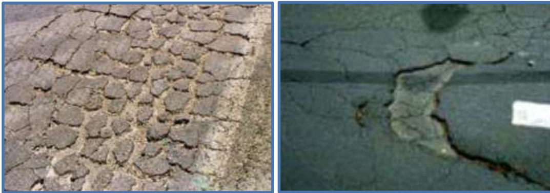
Pérdida de material piel de cocodrilo Fisuración parabólica con pérdida por deslizamiento
