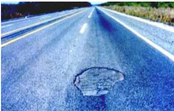
Fig. 1.1 Sup. pavimento dañado 1
