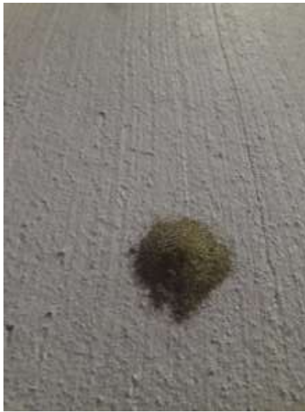
Figura N° 65 Depósito de arena sobre losa.
