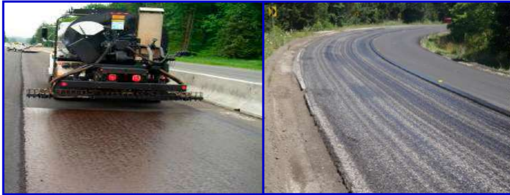
Figura 2.13. Defectos ocurridos durante la dotación del riego [izquierda: Riego de liga uniforme; derecha: Riego no uniforme]
