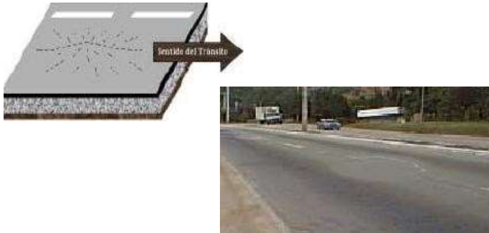
Figura N° 11: Daño por hinchamiento.
