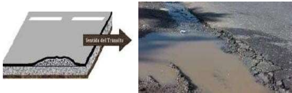
Figura N°15: Daño por designación de bordes con acumulación de agua
