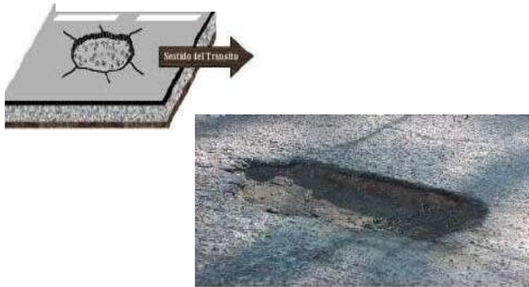
Figura N°13: Bache con pérdida de material de base
