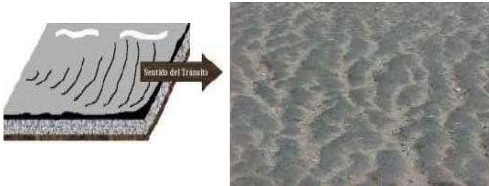
Figura N°9: Daño por corrimiento
