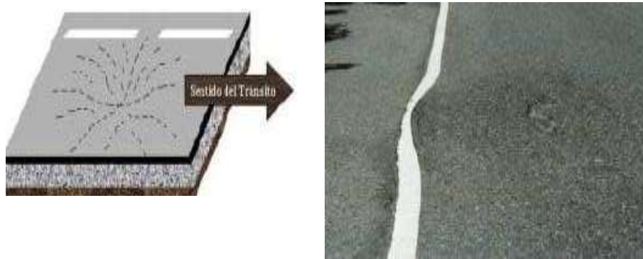
Figura N° 12: Daño por hundimiento
