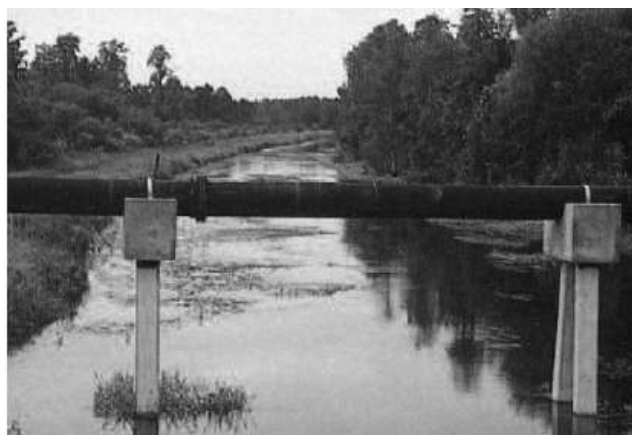
Fotografía 3-2: TUBOS DE HIERRO DÚCTIL SUSPENDIDOS
