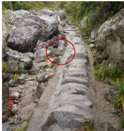
Fotografía 5-3: PÉRDIDA DE AGUA POR INFILTRACIÓN
