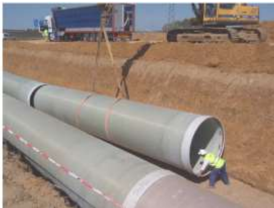
Figura 3.13: TUBERÍA DE PRFV DN 2000
