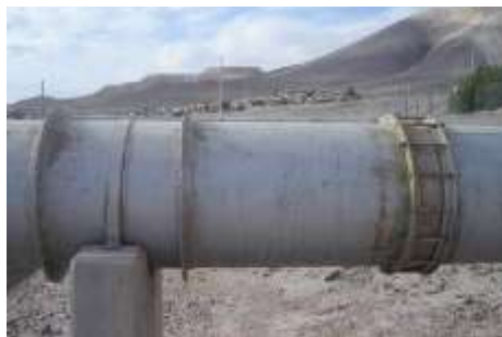
Figura 3.27: TUBERÍA SOBRE SILLAS DE APOYO
