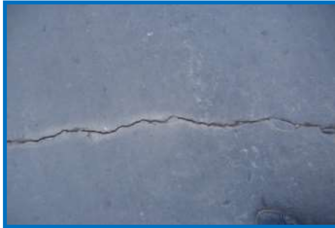
Figura 3.81: Fisura en pavimento flexible
