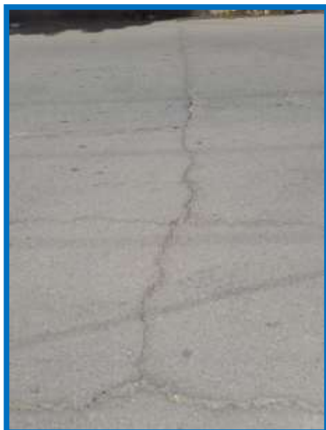
Figura 3.54: Fisura en bloque
