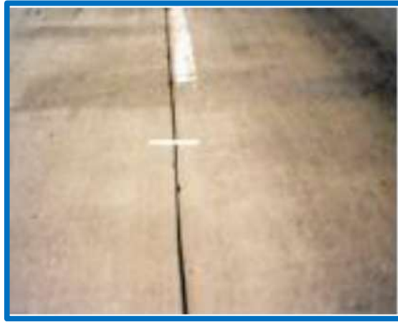
Figura 2.15: Vista típica de una separación de junta
