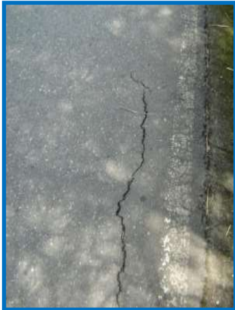
Figura 3.53: Fisura de borde
