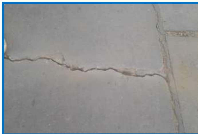
Figura 3.97: Grieta en pavimento rígido
