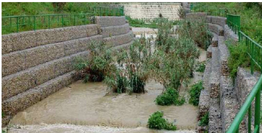
Figura 4.7. Cauce de un río revestido con gaviones.
