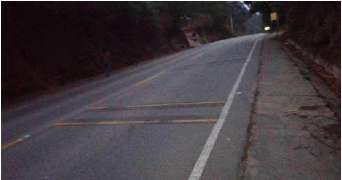
Figura N° 3.34. Reductores de velocidad en mal estado TCA 4
