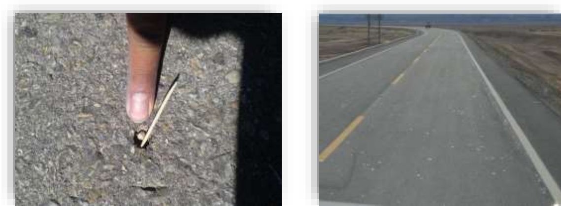
Fotografía 3.5. Desprendimiento de agregados: Tramo Uyuni – Condo K
