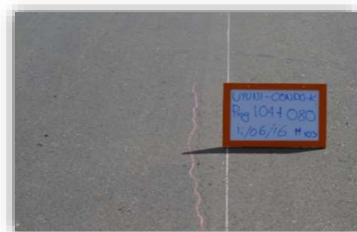
Fotografía 3.6. Fisuras en el eje: Tramo Uyuni – Cruce Condo K
