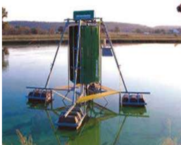
Figura 2.14. Sistema de aireación superficial
