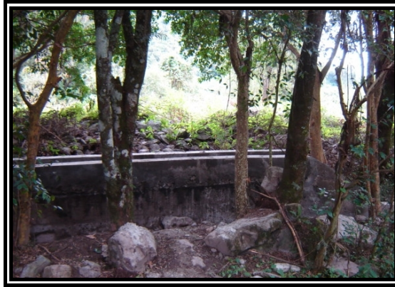
Figura N° 2.4: Canal de Riego Existente en mal Estado
