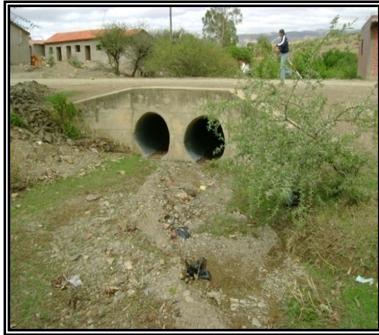
Figura N°3.6: Batería de Alcantarillado de 1 Metro de Diámetro
