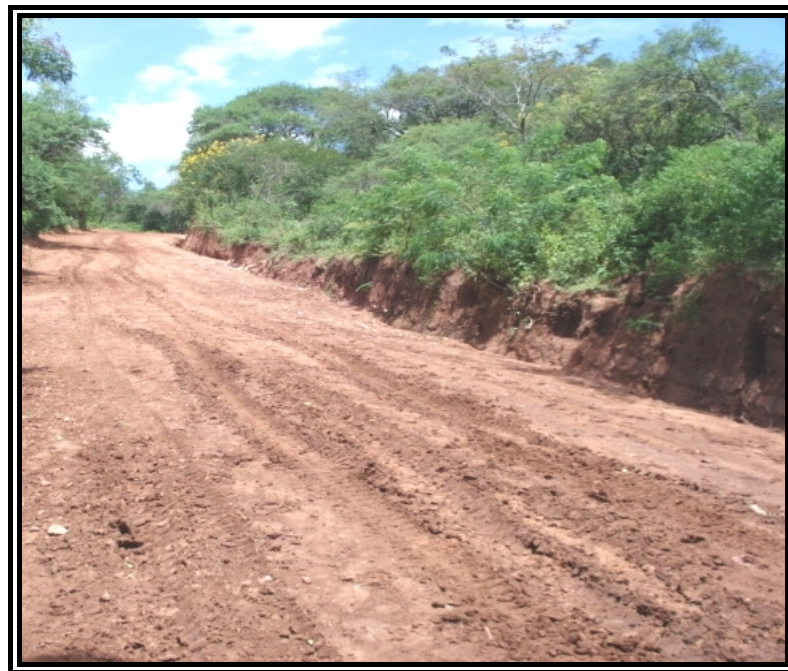
Figura N° 2.3: Camino Actual Intransitable en Epoca de Lluvias
