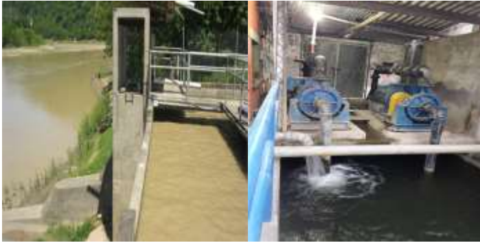
Figura 3. 6 Captación y bombeo de la obra de toma nueva del río Bermejo
