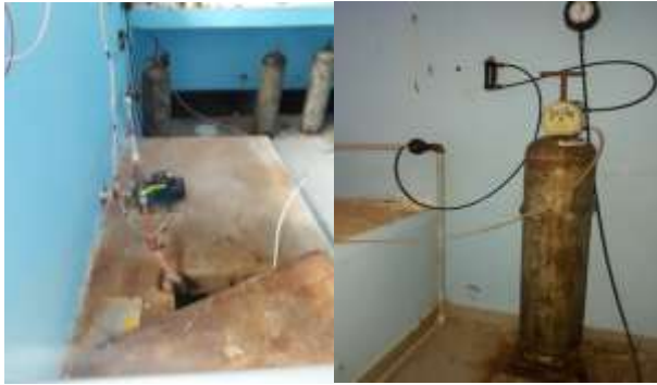
Figura 3. 20 Caseta de cloración
