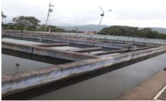
Figura 3. 17 Canal de reparto a sedimentadores
