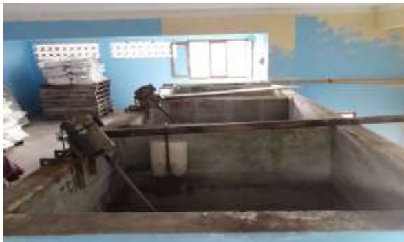
Figura 3. 12 Unidad de mezcla de químicos
