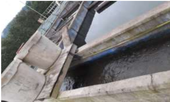
Figura 3. 15 Canal de reparto a floculadores
