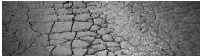
Figura 20. Fisuramiento de un pavimento
