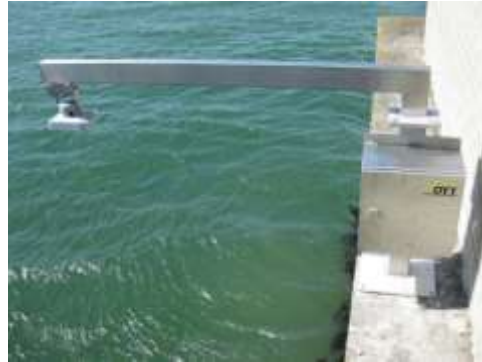
Figura 3.17. Pedestal para instalación de sensor de nivel de agua RLS
