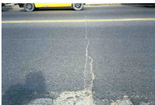
Figura 2.16 Nivel bajo de grieta transversal
