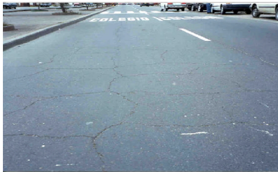
Figura 2.9 Nivel moderado de fisuramiento en bloque
