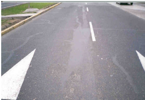
Figura 2.8 Nivel moderado de exudación
