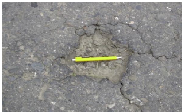
Figura 2.20 Hueco de media severidad
