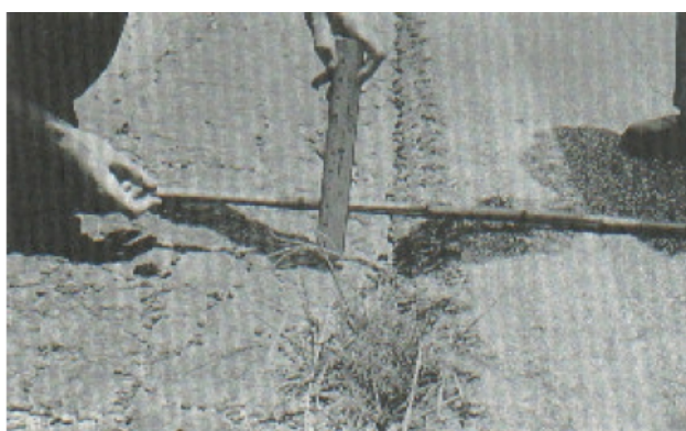
Figura 2.15 Desnivel carril / berma de media severidad
