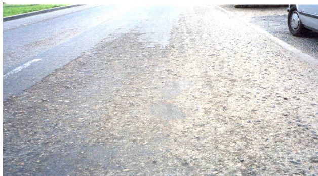
Figura 2.27 Nivel bajo de desprendimiento de agregados
