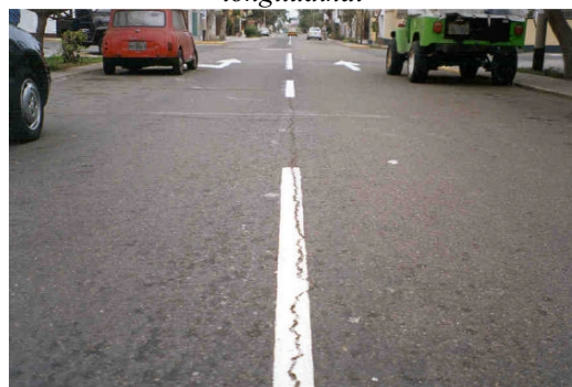
Figura 2.17 Nivel moderado de grieta longitudinal
