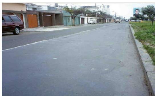
Figura 2.24 Desplazamiento de baja severidad
