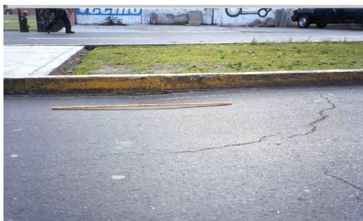
Figura 2.10 Nivel moderado de abultamiento y hundimientos
