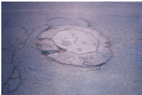
Figura 2.21 Tapa de alcantarillado de media severidad
