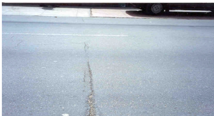
Figura 2.14 Nivel bajo de grietas por reflexión de juntas
