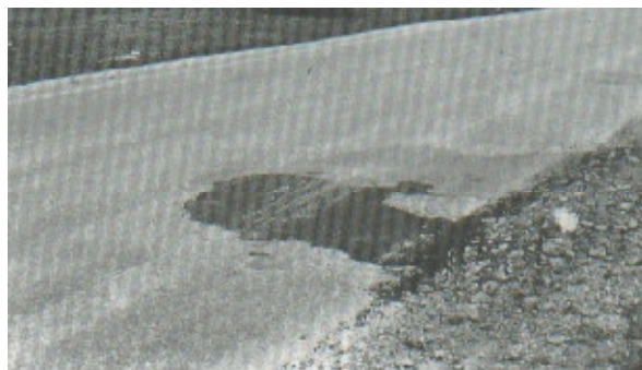
Figura 2.18 Parcheo y acometidas de servicios públicos de media severidad
