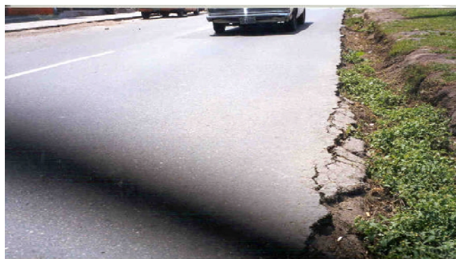
Figura 2.13 Grieta de borde de alta severidad
