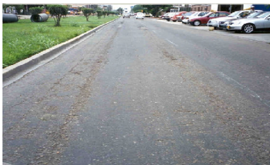
Figura 2.23 Nivel alto de ahuellamiento
