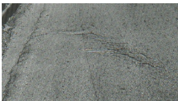
Figura 2.25 Grieta parabólica de media severidad
