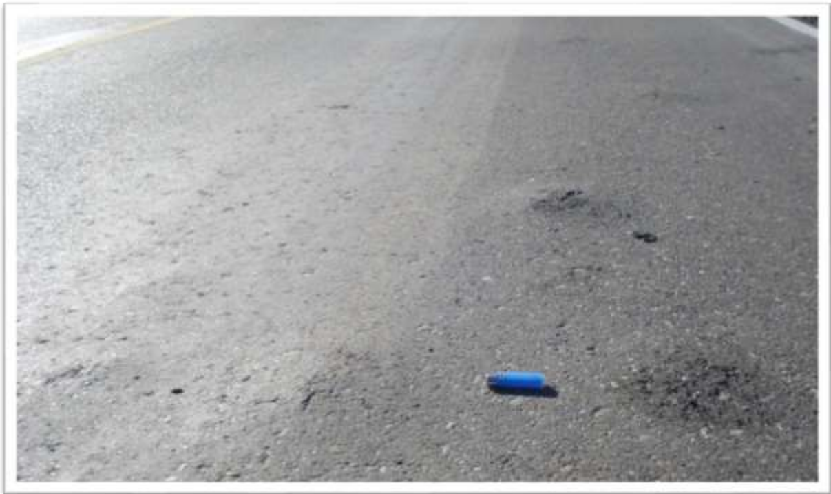
Fig. 3.4.1.2.4 Caso N° 1, Ampollas En Superficie De Pavimento Flexible
