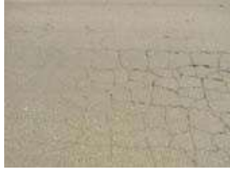
Fig. 2.5.1.1.2 – Fisuras y Grietas En Bloque
