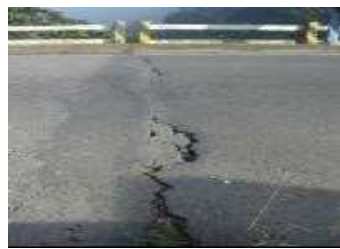
Fig. 2.5.1.1.5 – Fisuras Y Grietas Reflejadas
