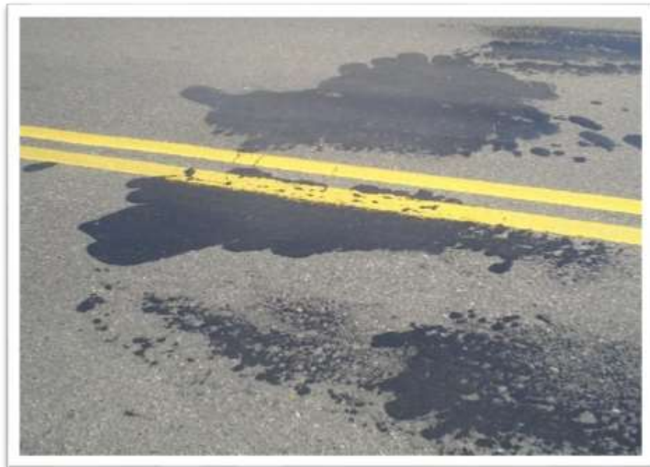
Fig. 3.4.1.1.2. Manchas por exudación de mástico asfáltico
