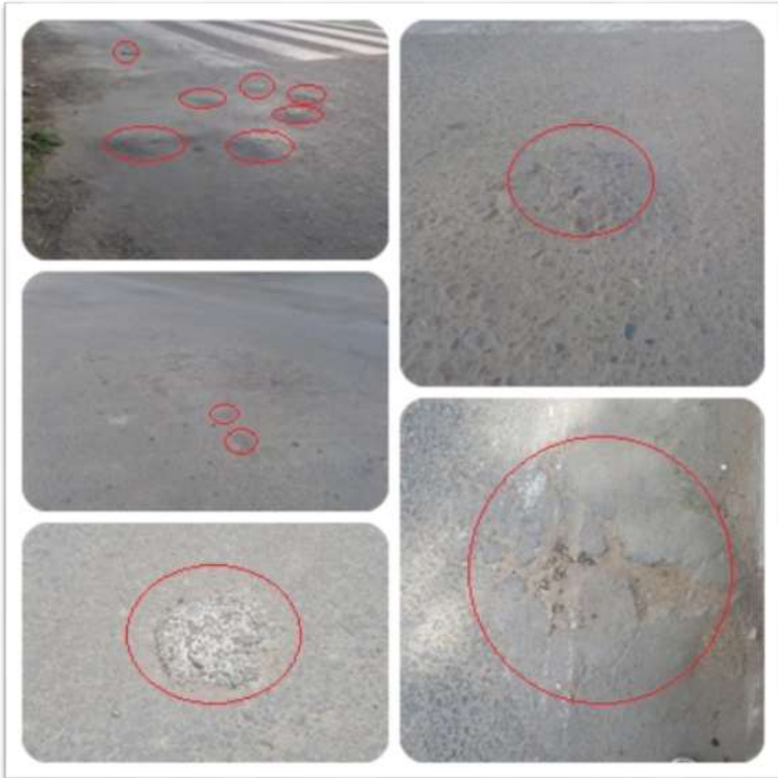
Fig. 3.4.1.2.1 – Imagen De La Identificación Y Marcación De Las Fallas Tipo Ampollas
