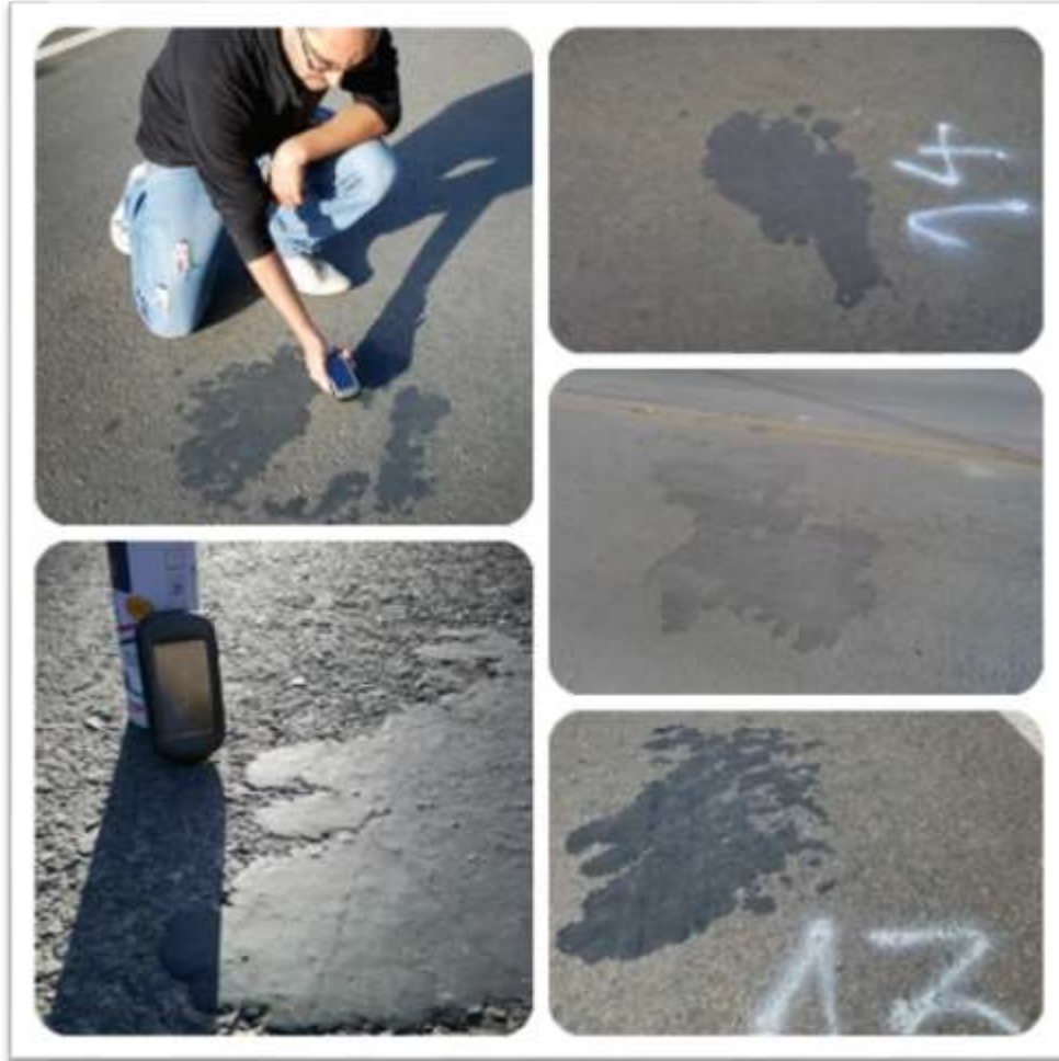
Fig. 3.4.1.1.1 – Imagen de la identificación y marcación de las fallas tipo exudación
