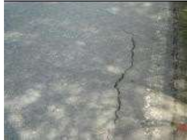
Fig. 2.5.1.1.3 – Grietas De Borde
