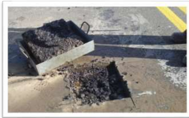
Fig. 4.1.2. Extracción de muestra de pavimento en área exudada
