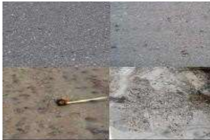
Fig. 2.5.1.2.7 – Perdida De Áridos
