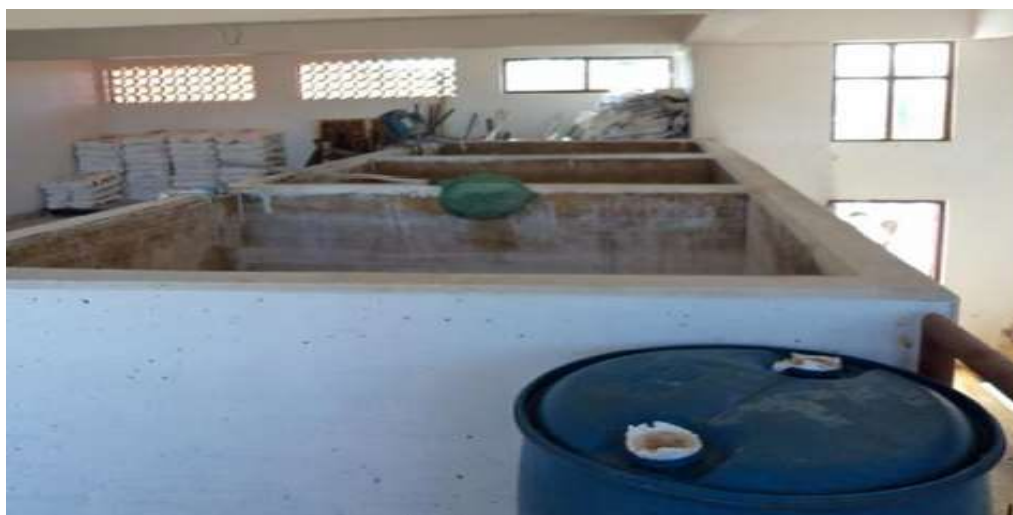
Fotografía 2.4 Tanques de mezcla de sulfato de aluminio
