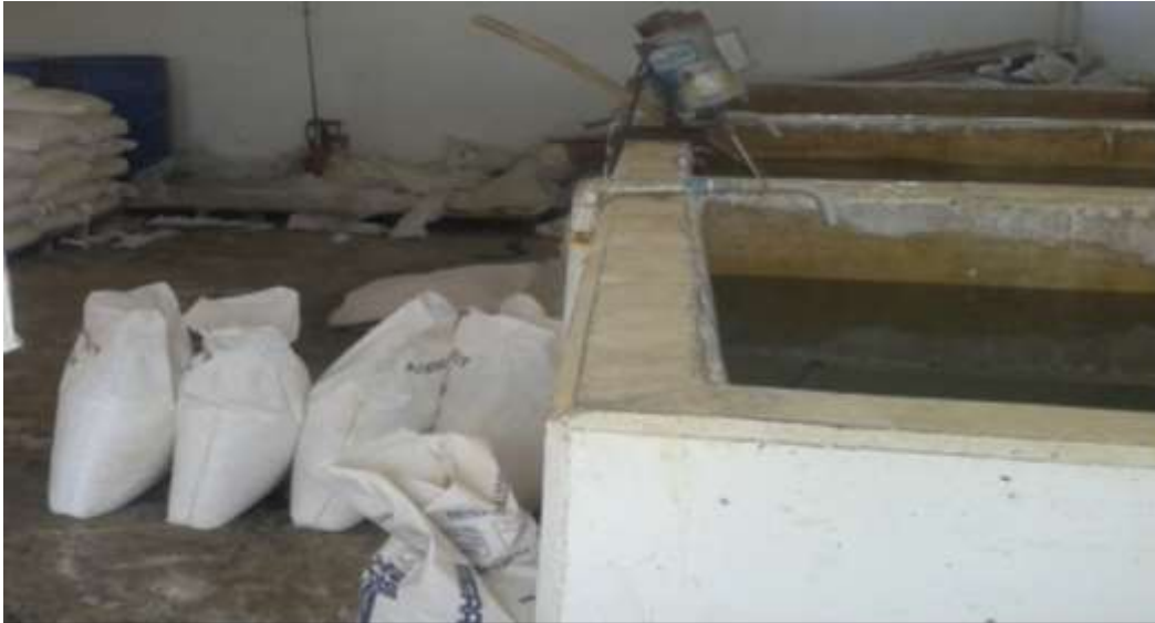
Fotografía 3.2 tanques de disolución de sulfato de aluminio
