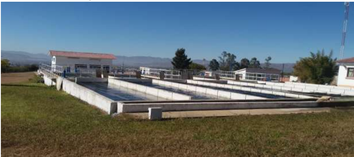
Fotografía N ro . 2.1 Planta de tratamiento Tabladita
