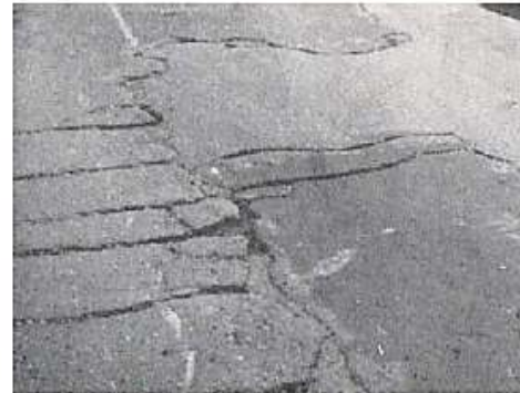
(Fisuras en Bloque)
