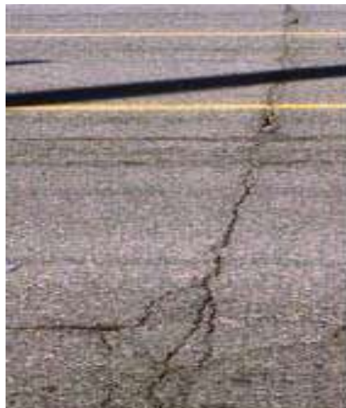
FIGURA N° 2. 20. Agrietamiento por bajas temperaturas
