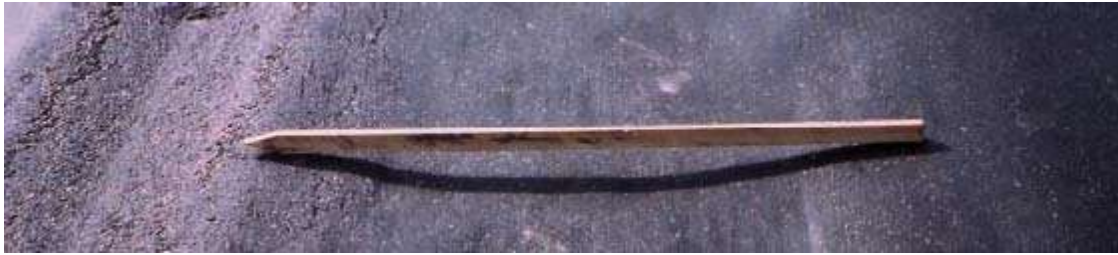
FIGURA N° 2. 19. Ahuellamiento o deformación permanente o rutting
