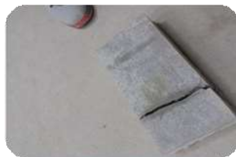
FOTOGRAFÍA 34. Rotura de Losas
