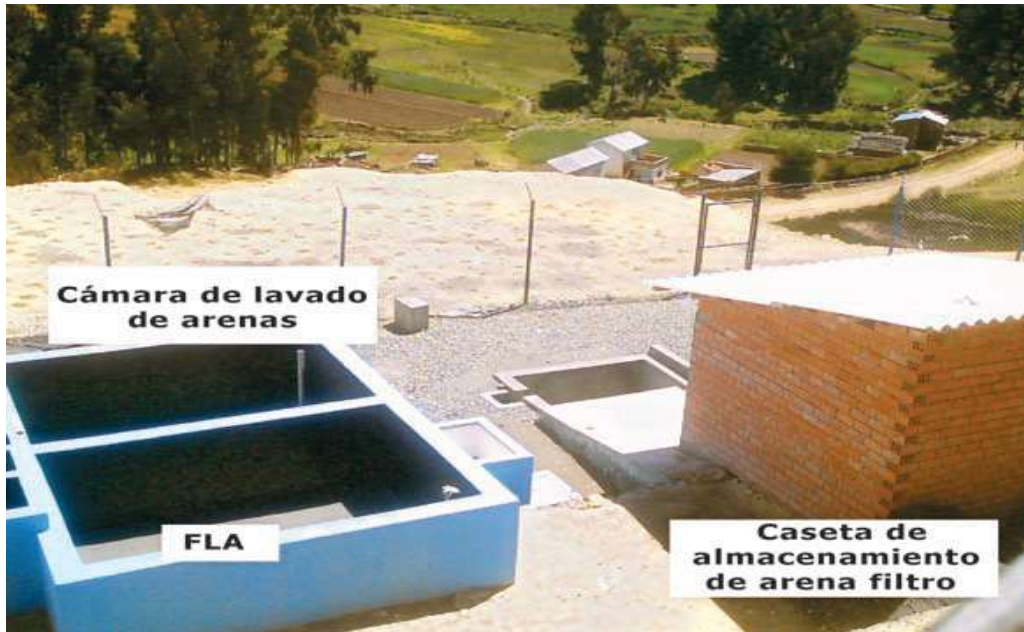
FIGURA 3. 28: Caseta de almacenamiento de arena filtro.
