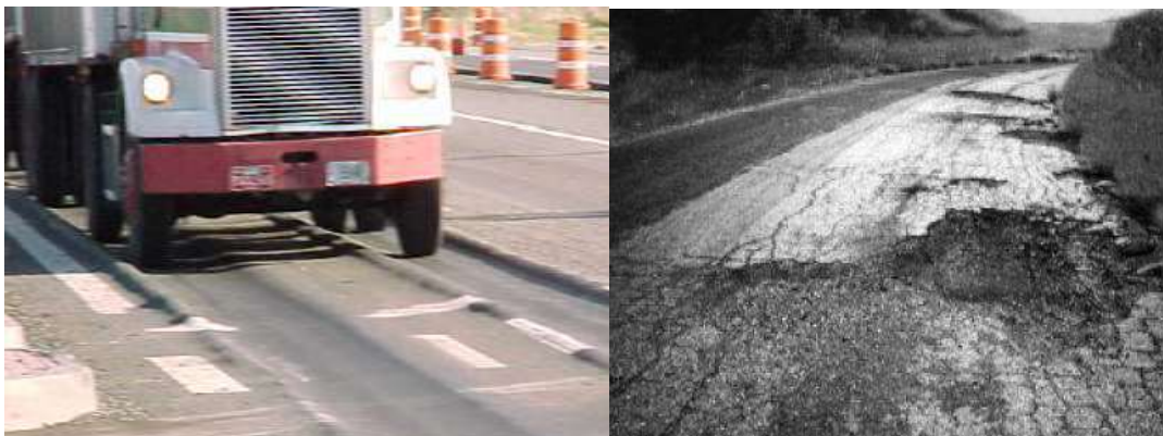
Figura16: Efectos De La Sobre Carga Vehicular Sobre El Pavimento
