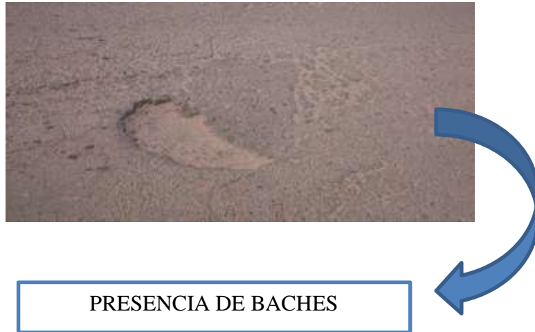
Figura 24: pavimento deteriorado (baches)
